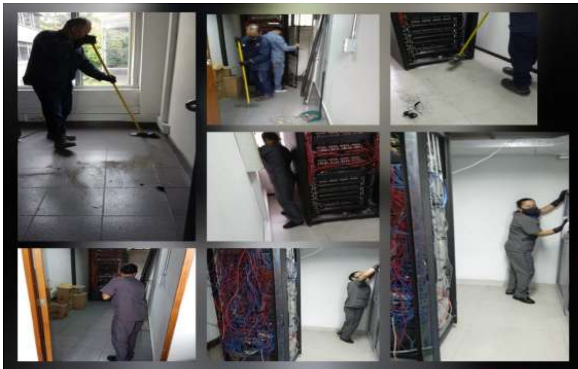
Limpieza de cuartos eléctricos Operarias 3.
