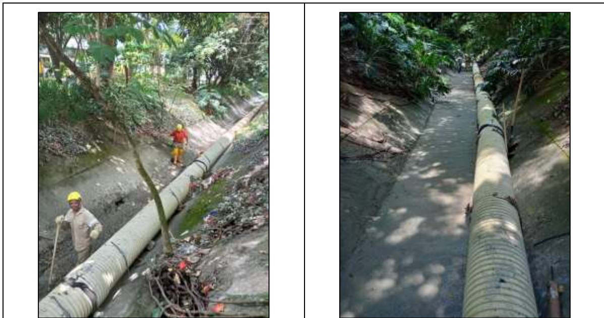
Ilustración 1. Mantenimiento quebrada Ana Díaz, 6 y 7 de octubre del 2025.
