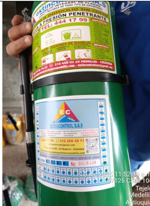
EXTINTOR DE AGUA DE 2 ½ GALONES
