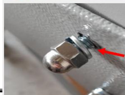
TORNILLO COMPLETA MENTE SUELTO, NO POSEE NINGÚN SISTEMA QUE IMPIDA QUE ESTOS SE SUELTEN CON FACILIDAD, NO POSEE TRABA QUÍMICA EN EL CUERPO DEL TORNILLO
