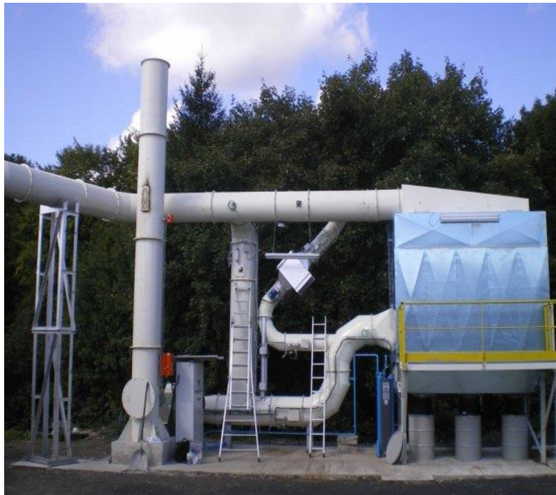
Sistema de control de emisiones para horno rotatorio Fuente: HORMESA AMERICA LTDA (Colombia).
