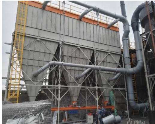
Sistema de control de emisiones para horno rotatorio Fuente: Productora Nacional de Metales S.A.S.
