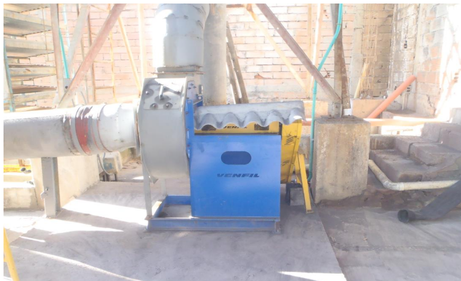
Ventilador tiro forzado
