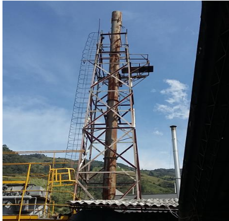
Ducto de salida de emisiones
