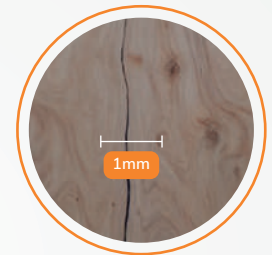
Fibra rota Ruptura completa de las fibras a lo largo del tablero
