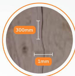
Separación superficial de las fibras del tablero (reparadas)
