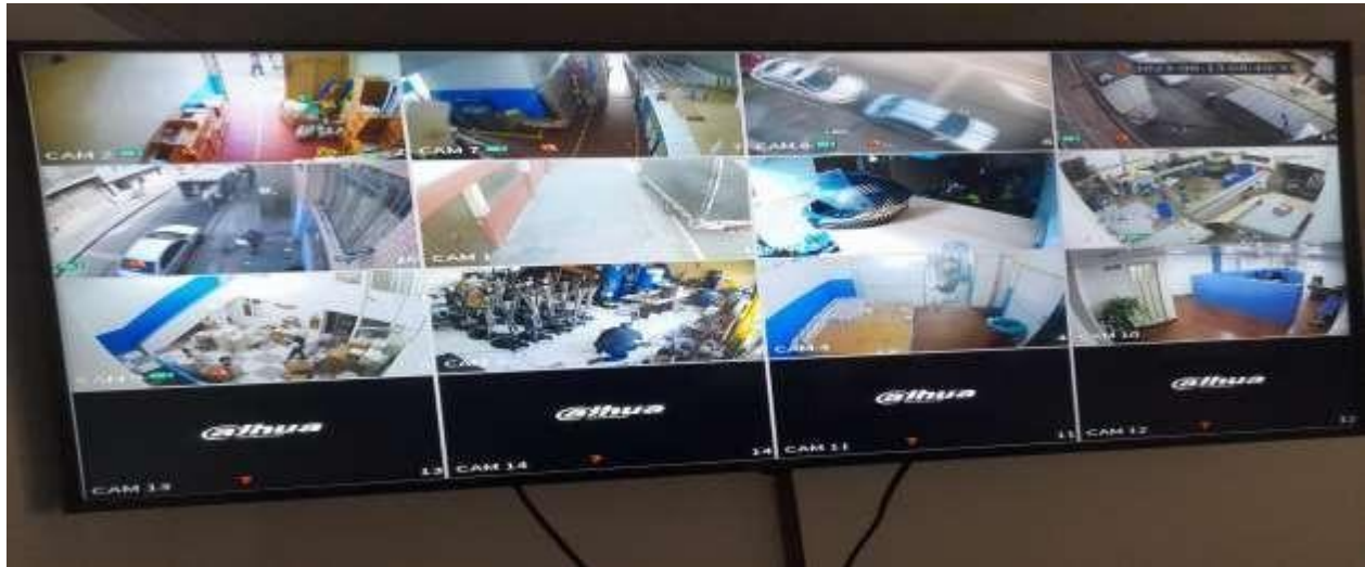
Ilustración 10. Sistema de seguridad de cámaras
