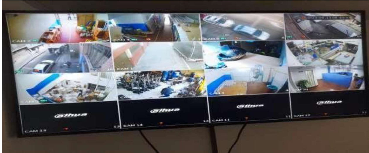
Ilustración 10. Sistema de seguridad de cámaras
