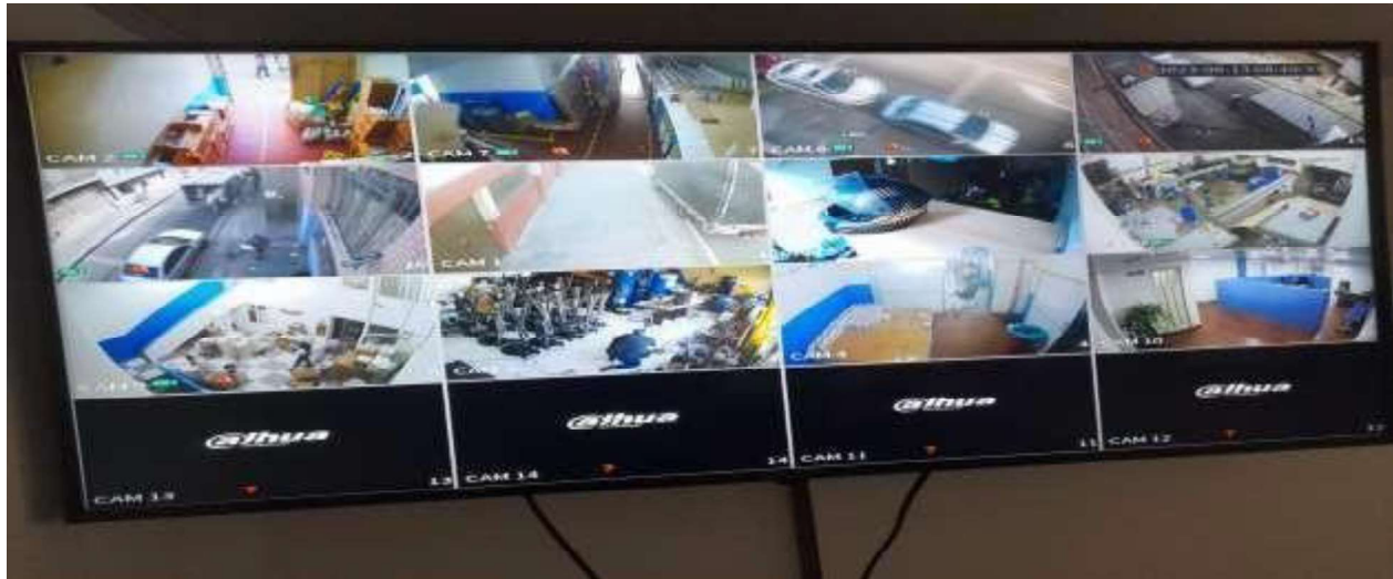
Ilustración 10. Sistema de seguridad de cámaras
